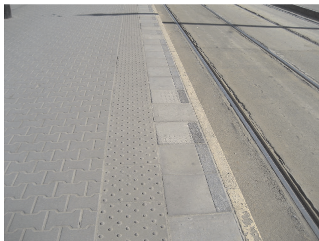
Rys. 8. Przykład niewłaściwego utrzymania krawędzi peronowej [fot. J. Poliński]
