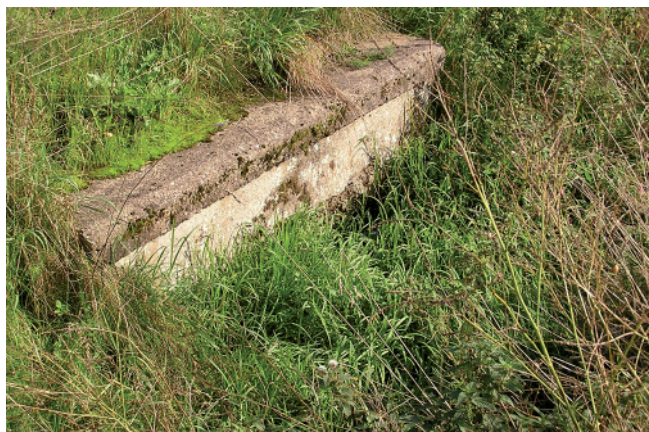
Rys. 6. Niedrożny przepust pod torami [zbiory Zakładu Dróg Kolejowych i Przewozów Instytutu Kolejnictwa]
