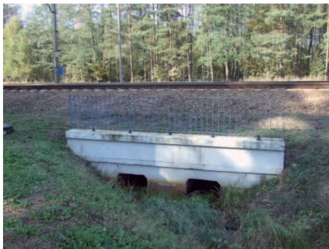
Rys. 4. Zarośnięty przepust pod torami [zbiory Zakładu Dróg Kolejowych i Przewozów Instytutu Kolejnictwa]
