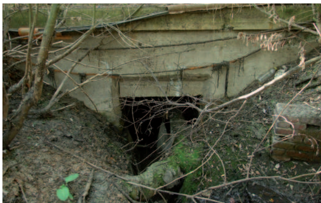
Rys. 8. Zniszczony przepust pod torami [zbiory Zakładu Dróg Kolejowych i Przewozów Instytutu Kolejnictwa]
