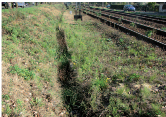
Rys. 3. Zanieczyszczony rów boczny [zbiory Zakładu Dróg Kolejowych i Przewozów Instytutu Kolejnictwa]
