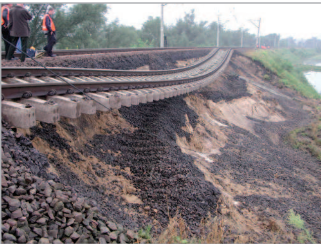
Rys. 16. Osuwisko nasypu obejmującego zasięgiem tor [5]
