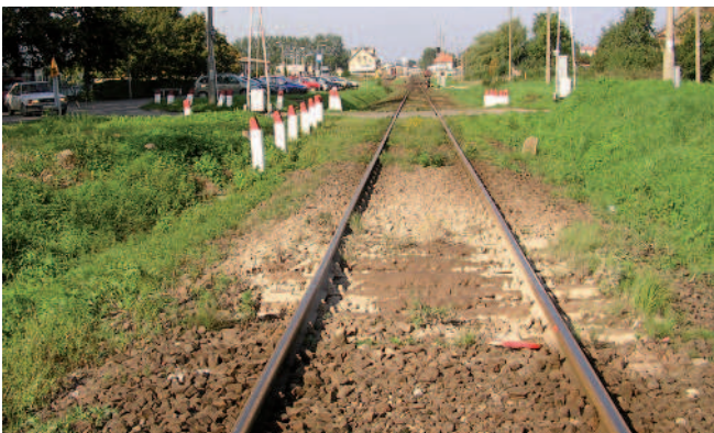
Rys. 11. Wychłapki spowodowane brakiem warstwy ochronnej torowiska [5]
