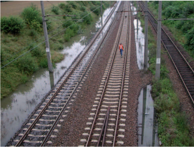
Rys. 15. Podtopienie podtorza z powodu niedrożnego odwodnienia [5]
