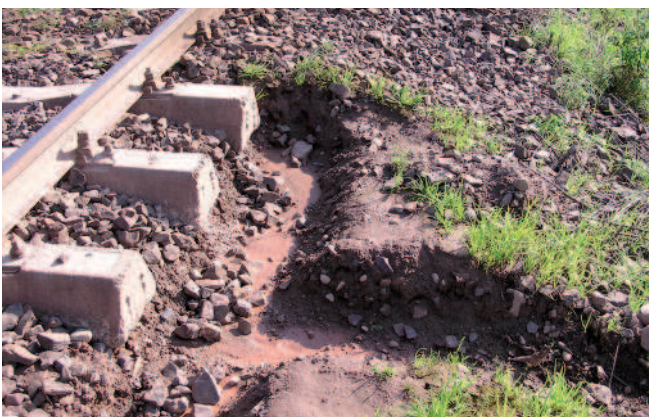
Rys. 12. Wyciskanie gruntu podtorza z powodu braku warstwy ochronnej torowiska [6]
