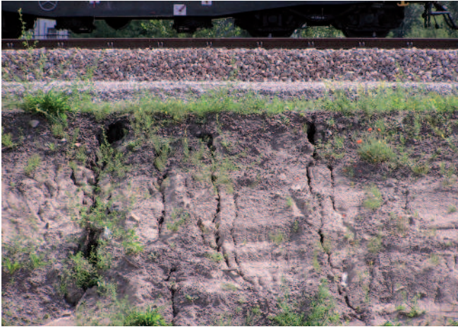
Rys. 10. Rozmycie nieumocnionej skarpy podtorza przez wody opadowe (tzw. abłacja deszczowa) [5]
