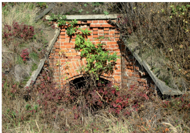
Rys. 5. Niedrożny przepust pod torami [zbiory Zakładu Dróg Kolejowych i Przewozów Instytutu Kolejnictwa]
