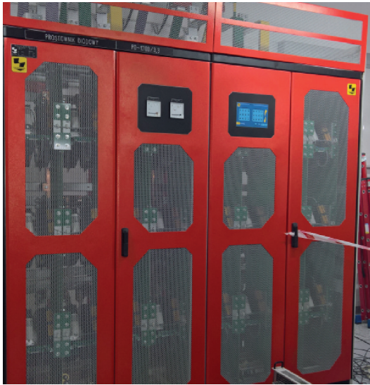
Rys. 15. Widok ogólny prostownika trakcyjnego PD-1700/3,3 EB, produkcji firmy ELEKTROBUDOWA S.A. [fot. W. Kruczek]
