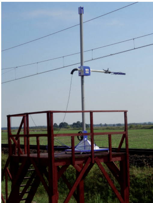
Rys. 5. Stanowisko EMC na Torze Doświadczalnym Instytutu Kolejnictwa w Żmigrodzie [fot. Ł. John]
