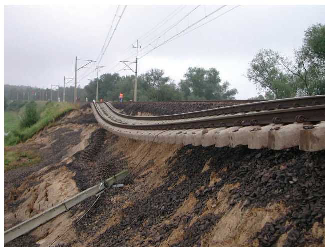
Rys. 3. Przykład osuwiska obejmującego tor [fot. zasoby własne Instytutu Kolejnictwa]
