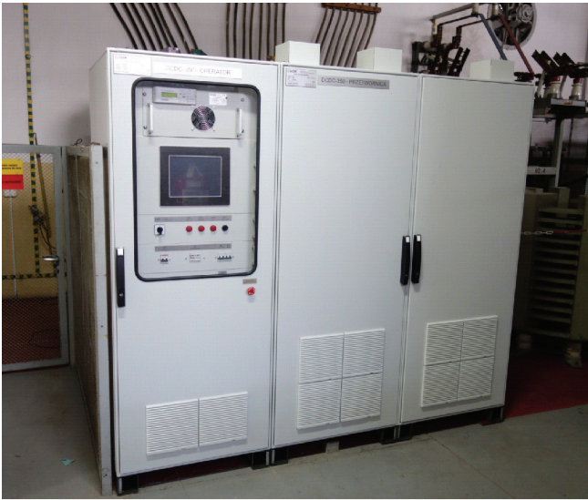
Rys. 5. Przetwornica DC/DC-350 w laboratorium zwarciovym Instytutu Kolejnictwa [1]
