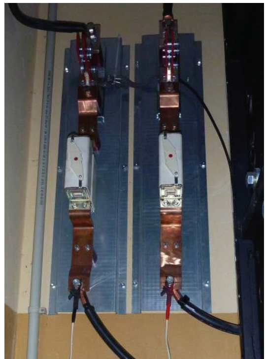
Rys. 8. Bezpieczniki oraz odłączniki na biegunach baterii akumulatorów [1]
