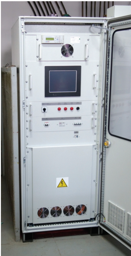
Rys. 6. Panel kontrolny i sterowniczy przetwornicy DC/DC-350 [1]
