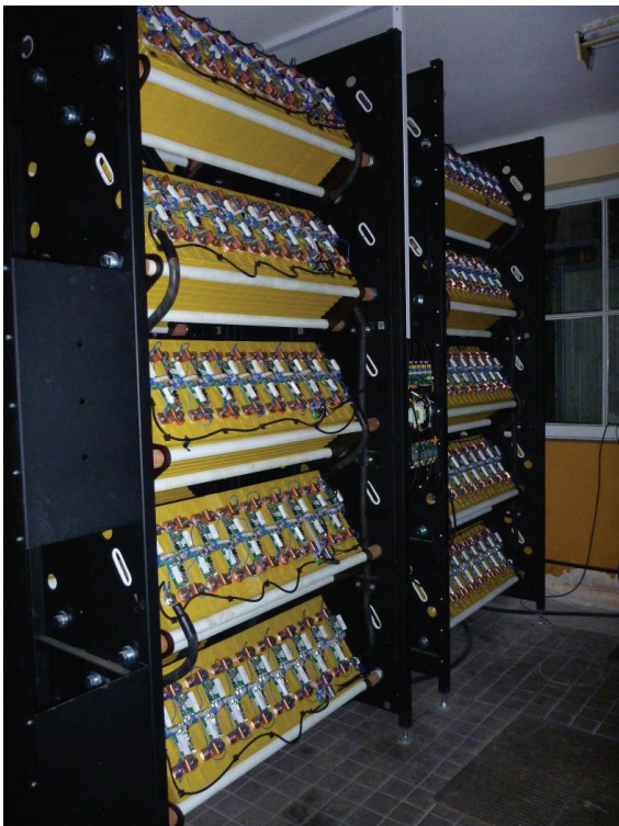
Rys. 2. Dwie z sześciu szaf baterii akumulatorów magazynu energii zainstalowanej w laboratorium zwarciovym Instytutu Kolejnictwa [1]
