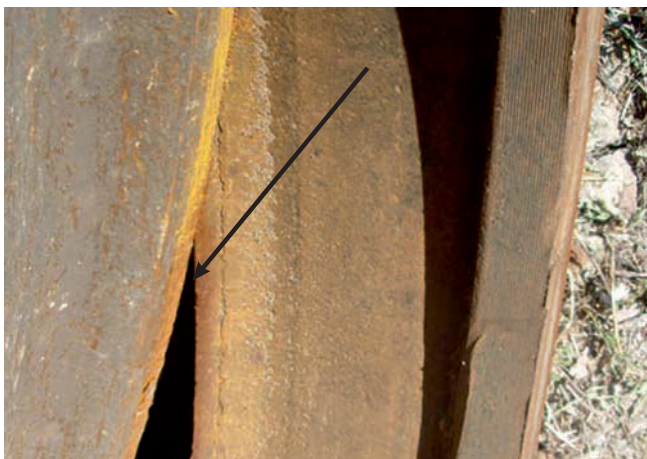
Rys. 4. Miejsce ścięcia pierścienia zaciskowego [fot. I. Mikłaszewicz]
