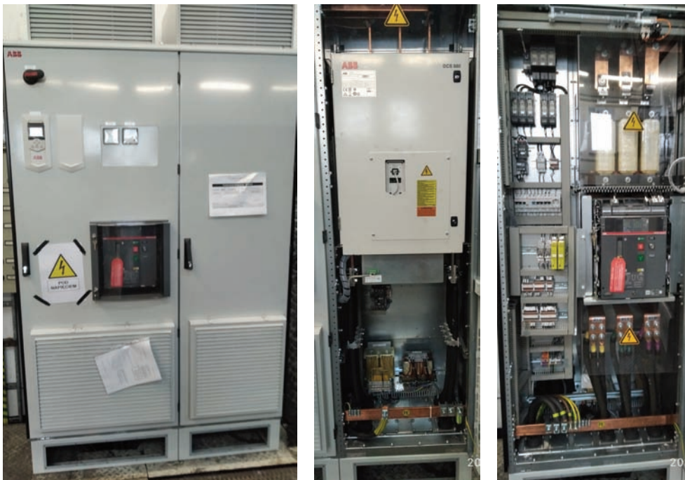
Rys. 10. Szafa sterowania silnika napędowego stanowiska [fot. J. Kukulski]
