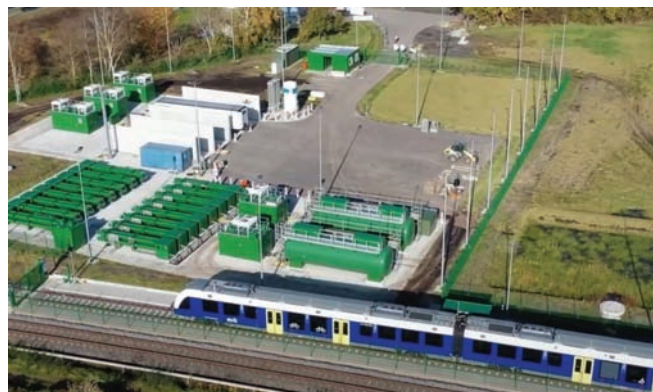
Rys. 1. Kolejowa stacja tankowania wodoru w Bremervörde, Niemcy [4]
