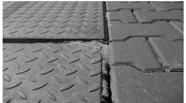
Rys. 1. Przykład niewłaściwie ułożonych płyt peronowych [fot. Piotr Gondek]
