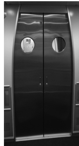
Rys. 19. Przegrody ogniowe zamykające przekrój poprzeczny [fot. A. Zbieć]
