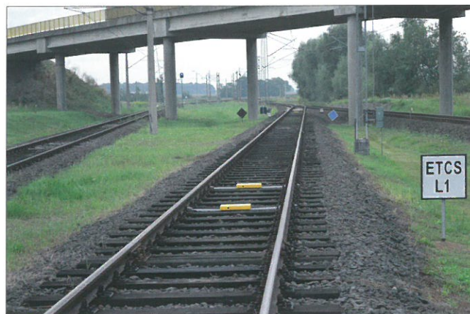
System ERTMS/ETCS poziom 1 - ALTRAC 6413 (wraz z balisami przyłączalnymi, nieprzełączalnymi i koderami LEU) fot. dr Andrzej Toruń
